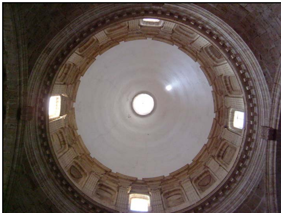
127- La cupola dall'interno in cui si intravedono le lesioni simmetriche.
